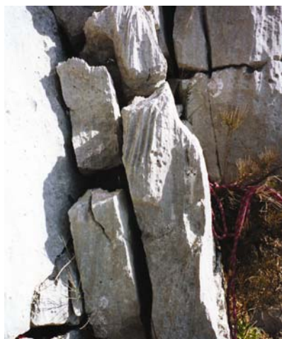
Pukotine u strmim stijenama
